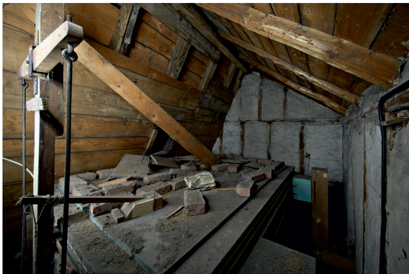
Abb. 58: Blick in die Windanlage der Chororgel von 1862 mit dem durch Steine beschwerten Magazinbalg oben und dem Windkanal zum außerhalb des Raums auf dem Chorbogen aufgestellten Gebläsemotor. (Foto: Roland Pieper, 2019)
