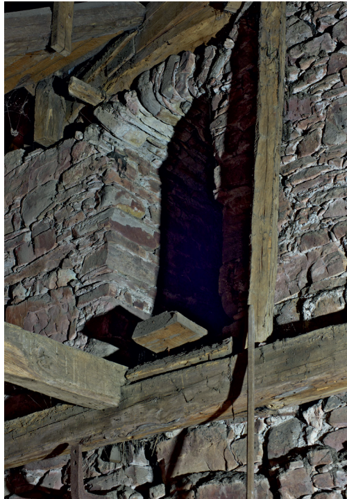
Abb. 68: Eine heute funktionslose Maueröffnung verweist auf eine Balkenlage als Zwischengeschoss innen und vermutlich eine Pechnase oder einen Ausguck außen ins Tal.
