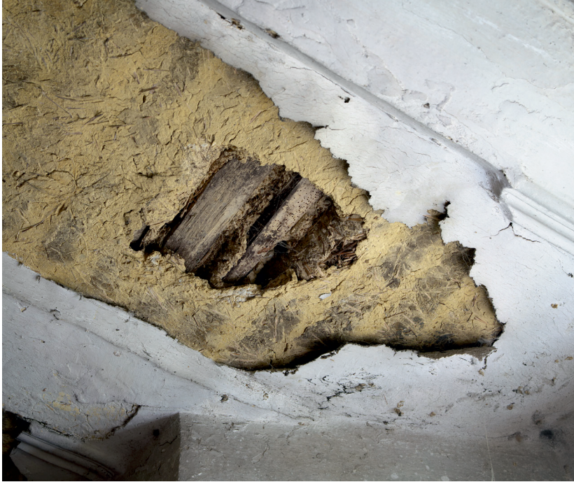
Abb. 49: Der Deckenaufbau im Westbereich der Kirche. Teils zweitverwendete Wellerhölzer wurden mit Lehmputz verstrichen. Erkennbar sind Reste von Stuckprofilen. (Foto: Roland Pieper, 2022)
